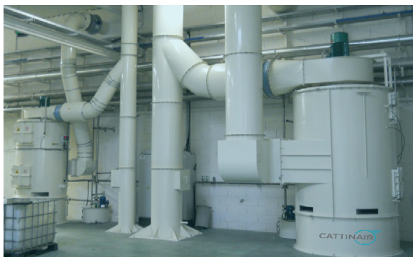
Application sur huiles entières et solubles avec filtres NOMF 2 et NOMF 8 et ventilateur intégré dans un process d'usinage moyeu avec un débit de 5 000 et 20 000m 3 /h.
