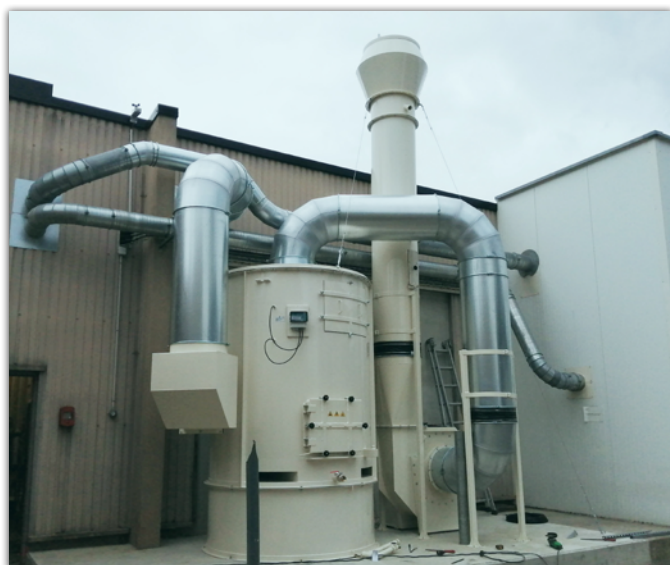
Intégration d'une filtre NOMF 6 pour aspirer les machines d'un atelier fer chez un fabricant de couteaux.
