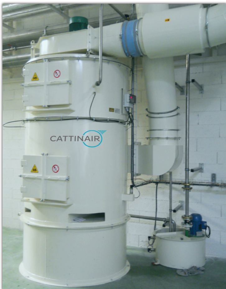
Système d'aspiration de brouillards d'huile chez un fabricant de roulements. Filtre NOMF 8 avec un débit d'air de 20 000m 3 /h.
